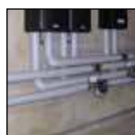
Rohrleitungsdämmung; wichtiger Faktor zur Reduktion des Energieverbrauchs
