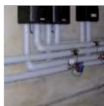
Rohrleitungs-dämmung; wichtiger Faktor zur Reduktion des Energieverbrauchs
