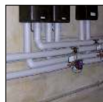
Rohrleitungs-dämmung; wichtiger Faktor zur Reduktion des Energieverbrauchs
