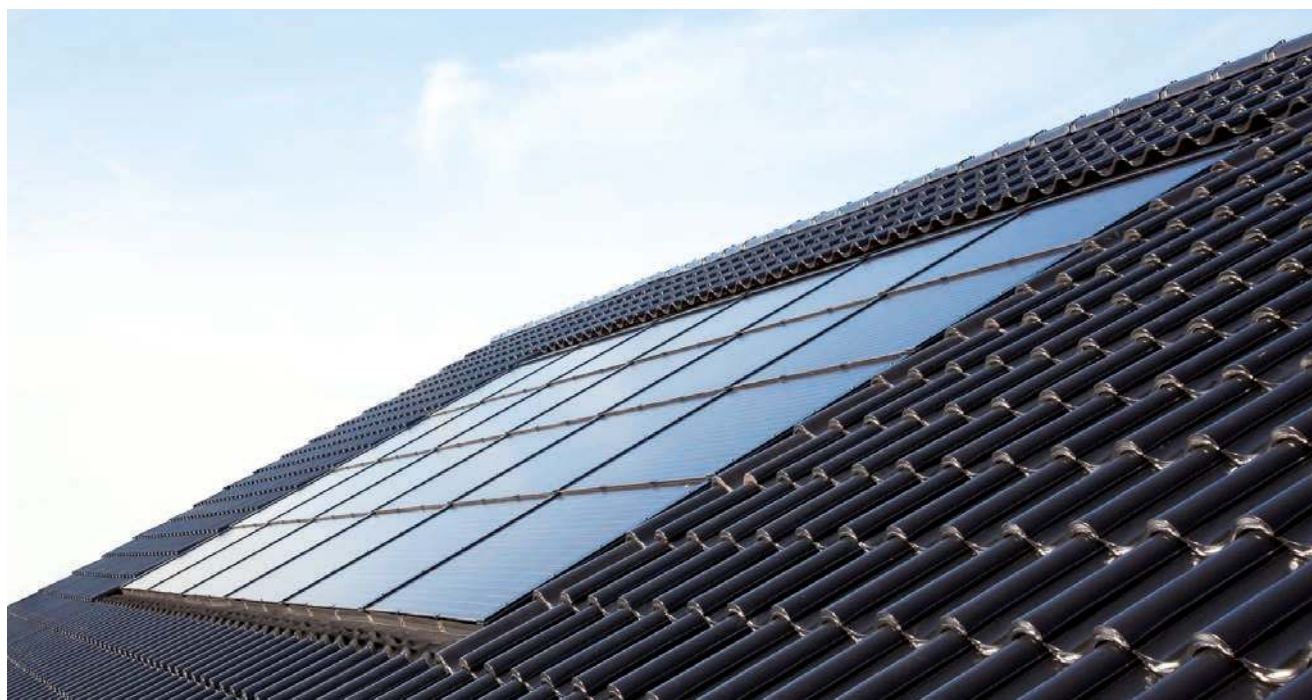
Unauffällig: Die Solaranlage ersetzt die eigentliche Dacheindeckung
